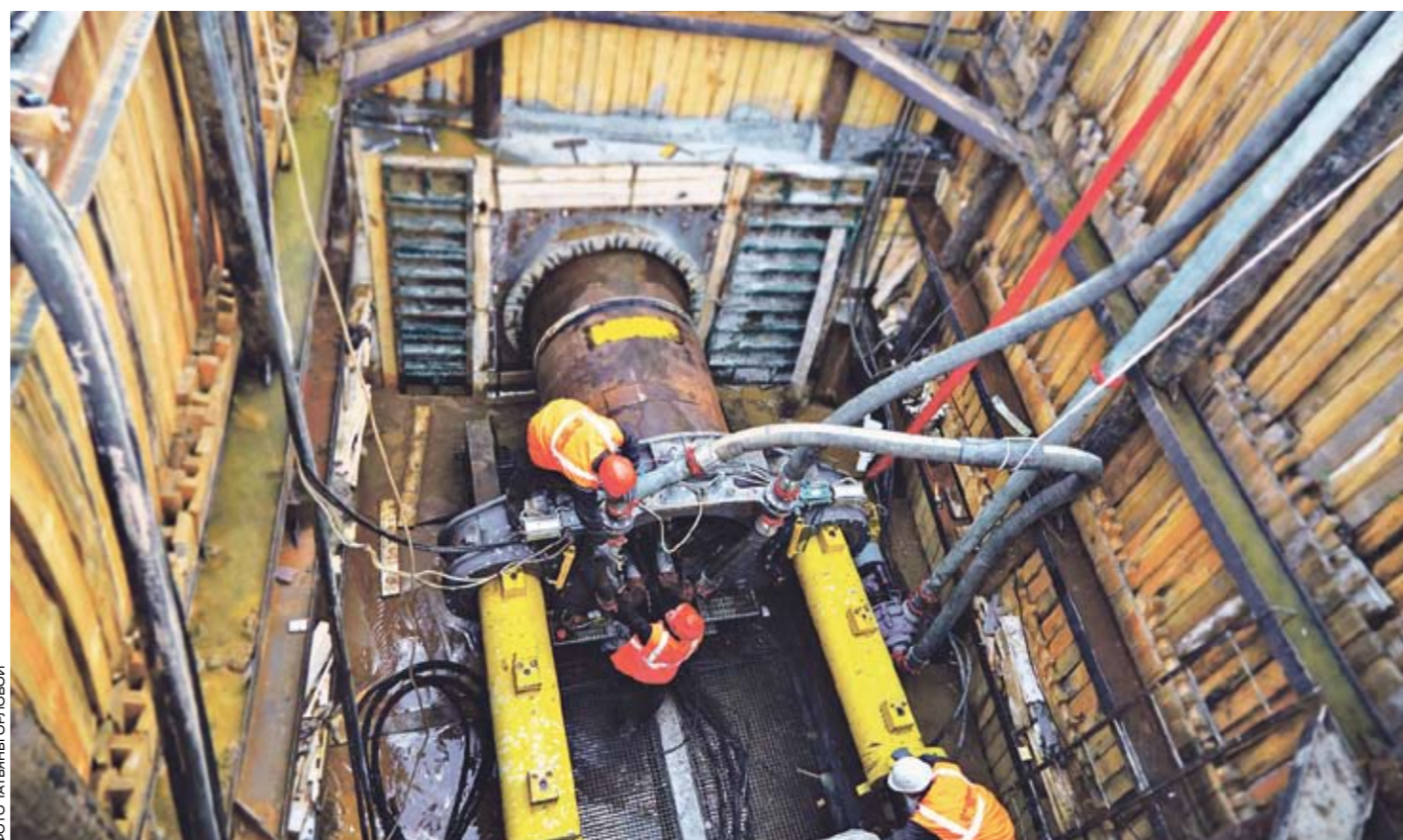
Бестрационная проходка с применением микротоннельных комплексов, установка горизонтальнонаправленного бурения и управляемого прокола помогает компании избежать неблагоприятного воздействия на экологию города
